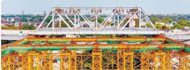
अहमदाबाद जिले में रेलवे ट्रैक के पास पश्चिमी रेलवे सुविधा-लॉन्डी के ऊपर लॉन्च किया गया पहला स्टील ब्रिज।
